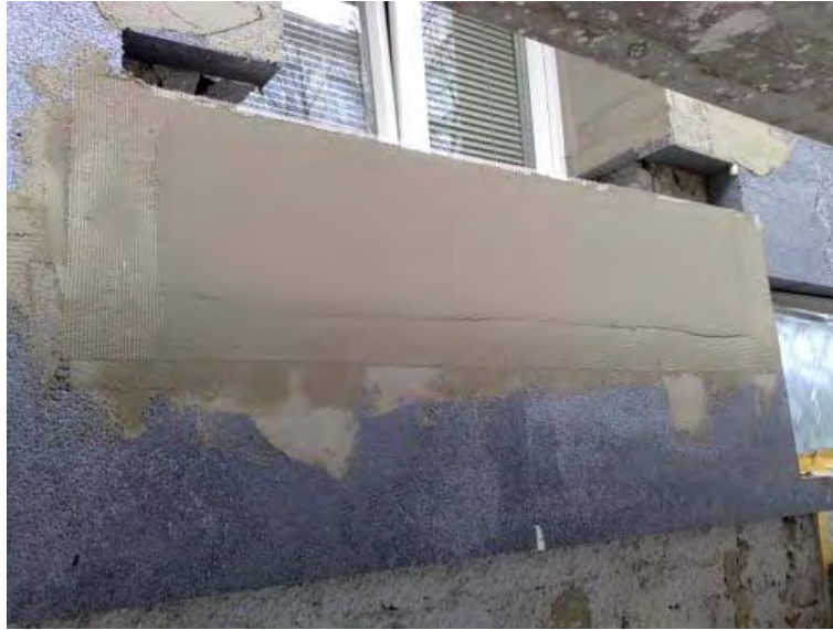
Abbildung 22: Bereiche unter den Fensterbänken mit Unterputz und Textilglasgitter vorbereitet, Malfattigasse 39 (Quelle: Hofer GesmbH)
