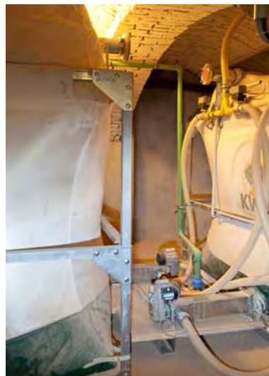
Abbildung 8: Pelletslagerraum nach Fertigstellung (Quelle: Gassner)
