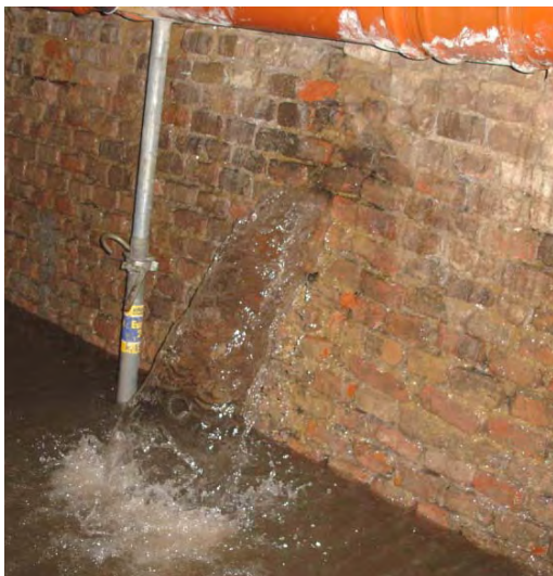
Abbildung 7: Überschwemmung Kellerräume während der Bauphase (Quelle: Gassner)
