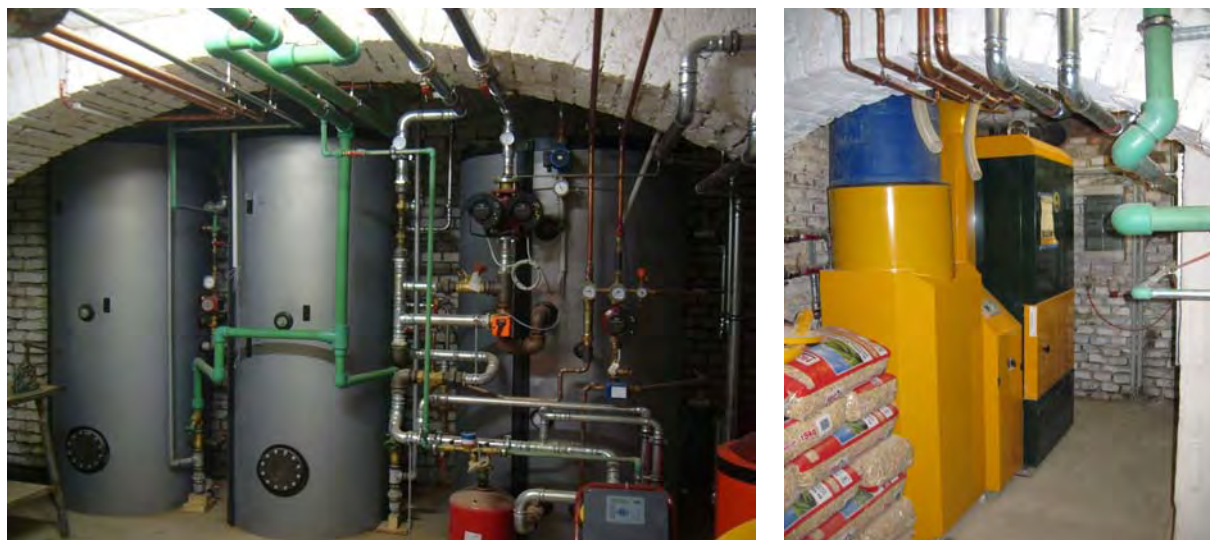
Abbildung 15: Haustechnikzentrale Wißgrillgasse (Fotos: e7)
