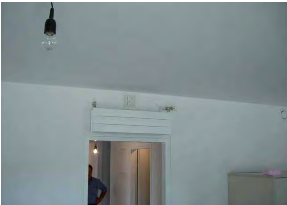
Abb. 44: Wohnhausanlage Kammelmweg, Detail Zuluftventil und Nachheizregister, Bauteil B
