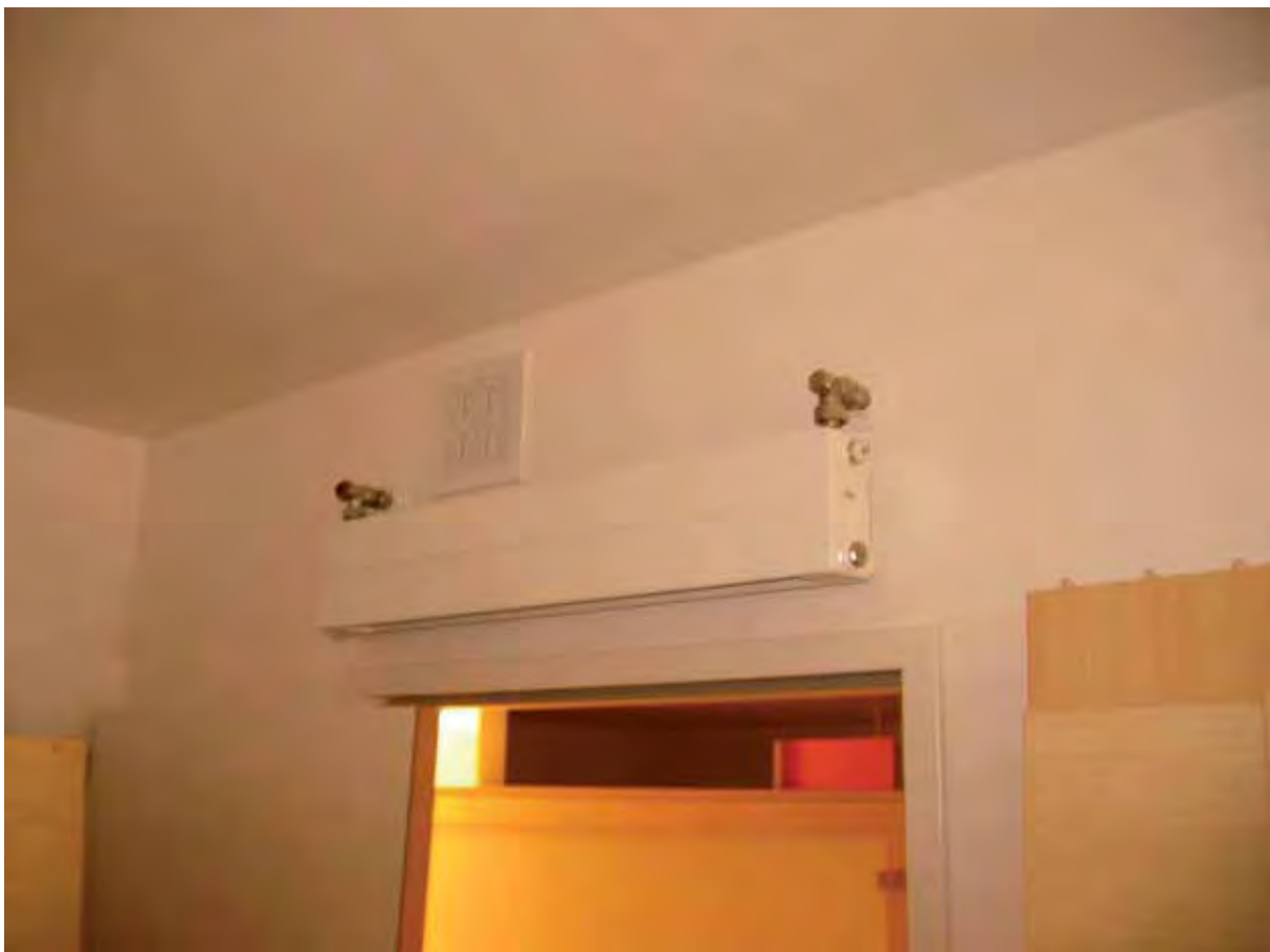
Abb. 38: Studentenheim Molkereistraße, Wien 2, Zuluft und Nachheizung
