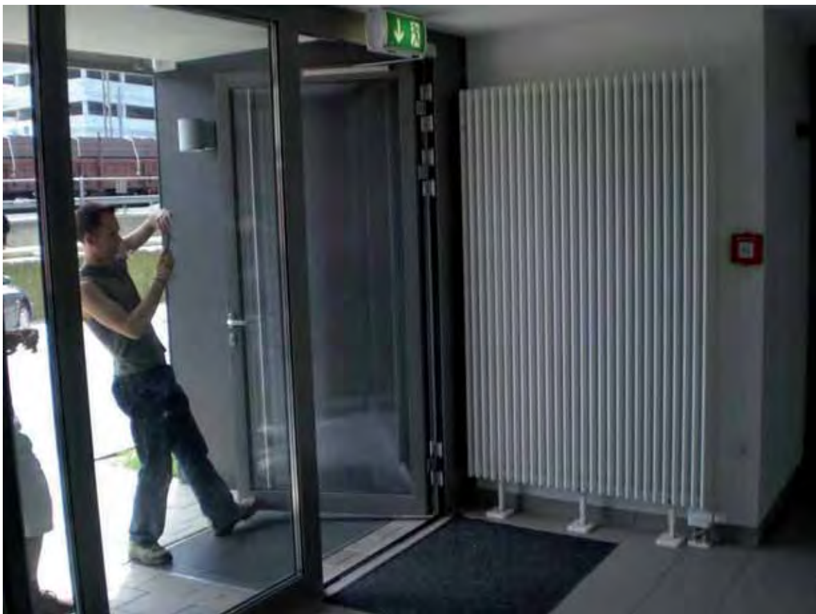
Abb. 43: Der Heizkörper im Eingangsbereich erregt Aufmerksamkeit
