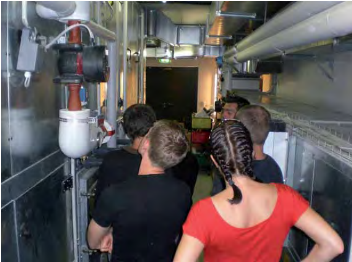
Abb. 24: .... und der Technikzentrale.
