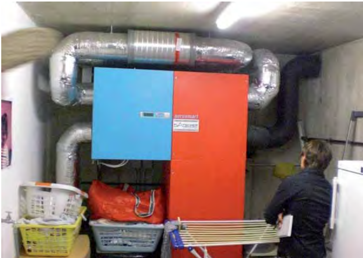
Abb. 4: Besichtigung der Haustechnik in einem der Reihenhäuser
