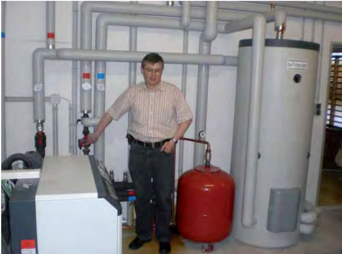
Abb. 12: Werner Rauchegger zeigt technische Details im Technikraum ...
