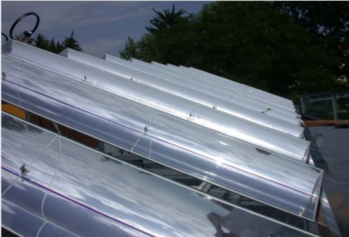
Kollektorfeld mit 10 Rinnen ~ 20 m 2
