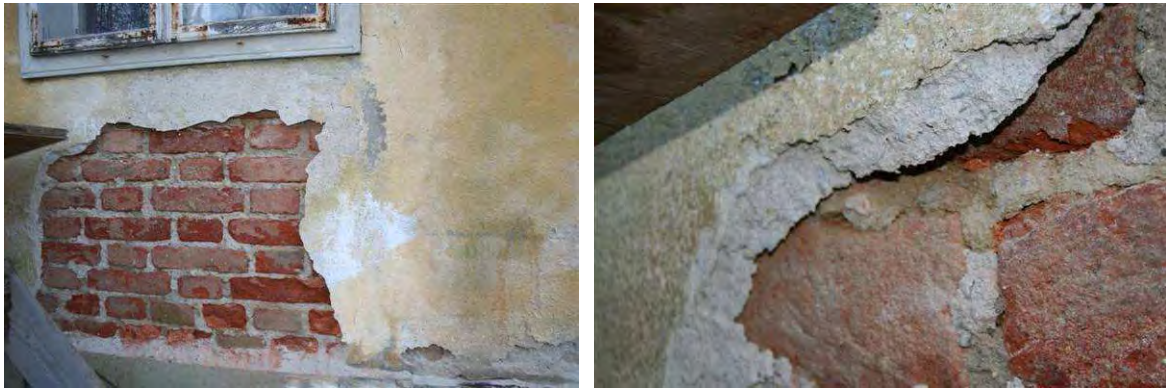
Abbildung 142: Großflächige Fehlstellen im Kalkputz der Außenfassade
