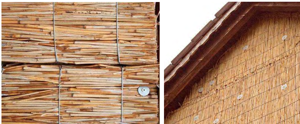
Abbildung 20: Links: Plattenstoß; rechts: improvisierte Lösung im Giebelbereich
