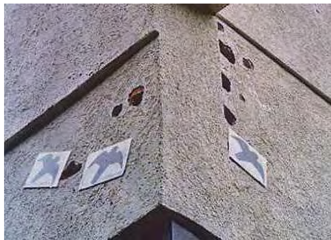
Abbildung 99: Mechanische Beschädigung eines Dünnschichtputzes durch Spechte 62
