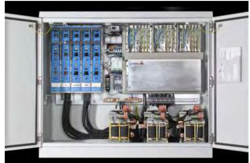
Schaltschrank mit 3 Phasen (250kVA; BxHxT = 160x130x50cm)
