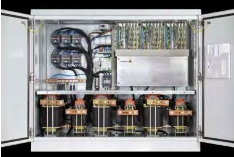
Schaltschrank mit 3 Phasen (630kVA; BxHxT = 160x130x50)
