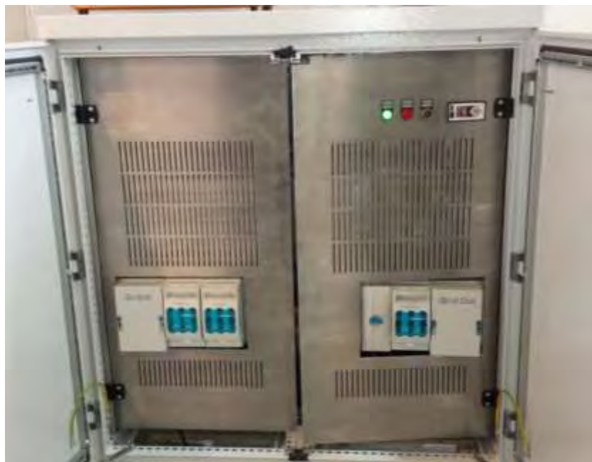
Schaltschrank mit 3 Phasen (110kVA; BxHxT = 120x130x40)
