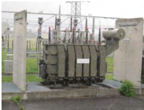
Regelung Trafostufung 110/30-kV-Umspanner UW Lungau, 32 MVA
