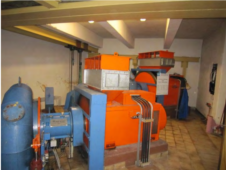
KW Graggaber M2 (400 kW) vorne, M1 (700 kVA) hinten
