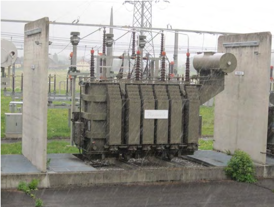
110/30-kV-Umspanner 32 MVA Nennleistung
