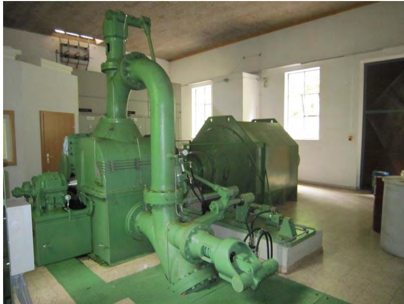
KW Kendlbruck (2500 kW), Turbine und Generator
