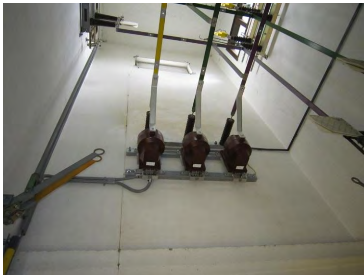
Spannungswandler für Messung
