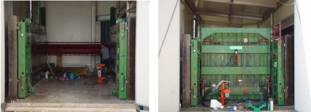
Abbildung 18: Aufbau des Prototypen – Einbau der Fräse und der Abschiebewand im überdachten Feststoffbehälter
