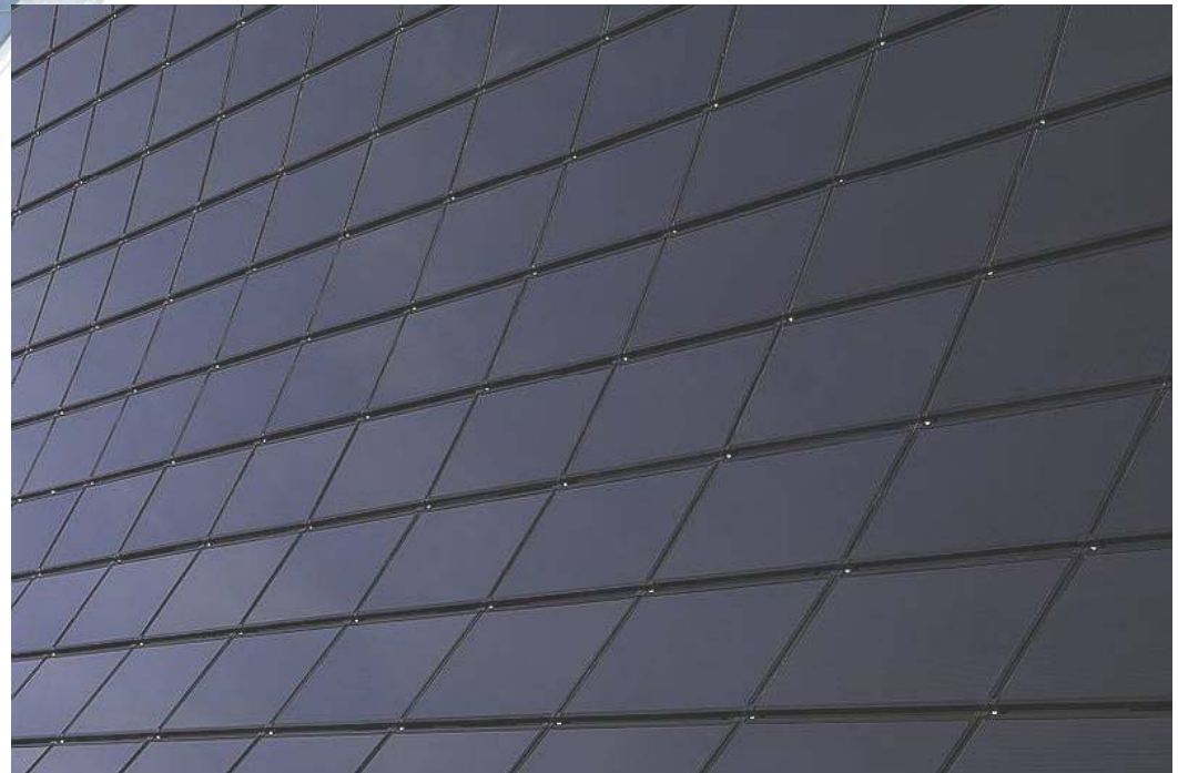
Detailansicht einer PV Fassade (CIS Module: Sulfurcell)
