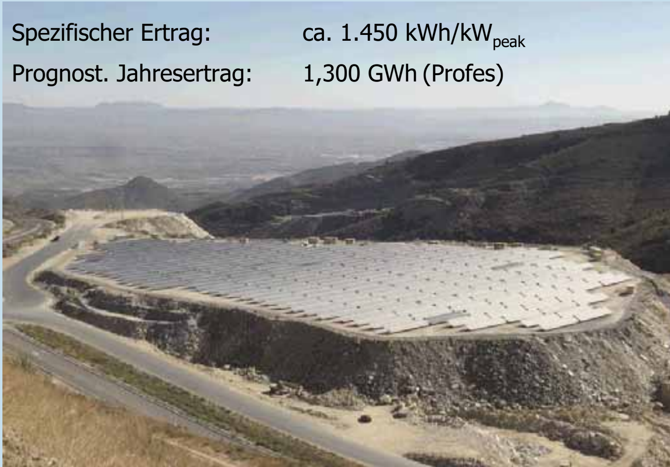
Ansicht der Gesamtanlage (1,5 MW)
