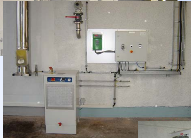
Gaskühler u. Steuerung
