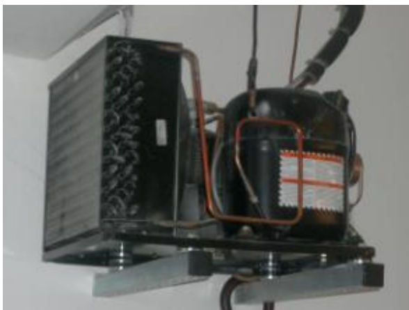
Abbildung 4.24: Dezentraler luftgekühlter Verflüssigungssatz in einem Kellergang
