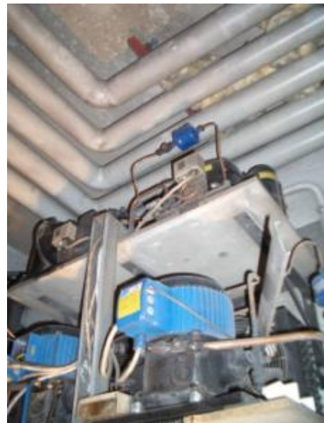
Abbildung 4.3: Kälteanlagen: Getränkekühlzellen, Fleischvorkühlraum und alte Tiefkühlzelle (in Kühlanlagenraum)
