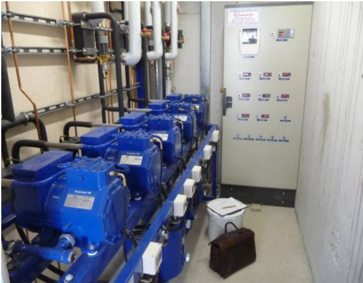
Abbildung 2.24: Kältemaschinen-Verbundsatz (nur die ersten drei Verdichter)
