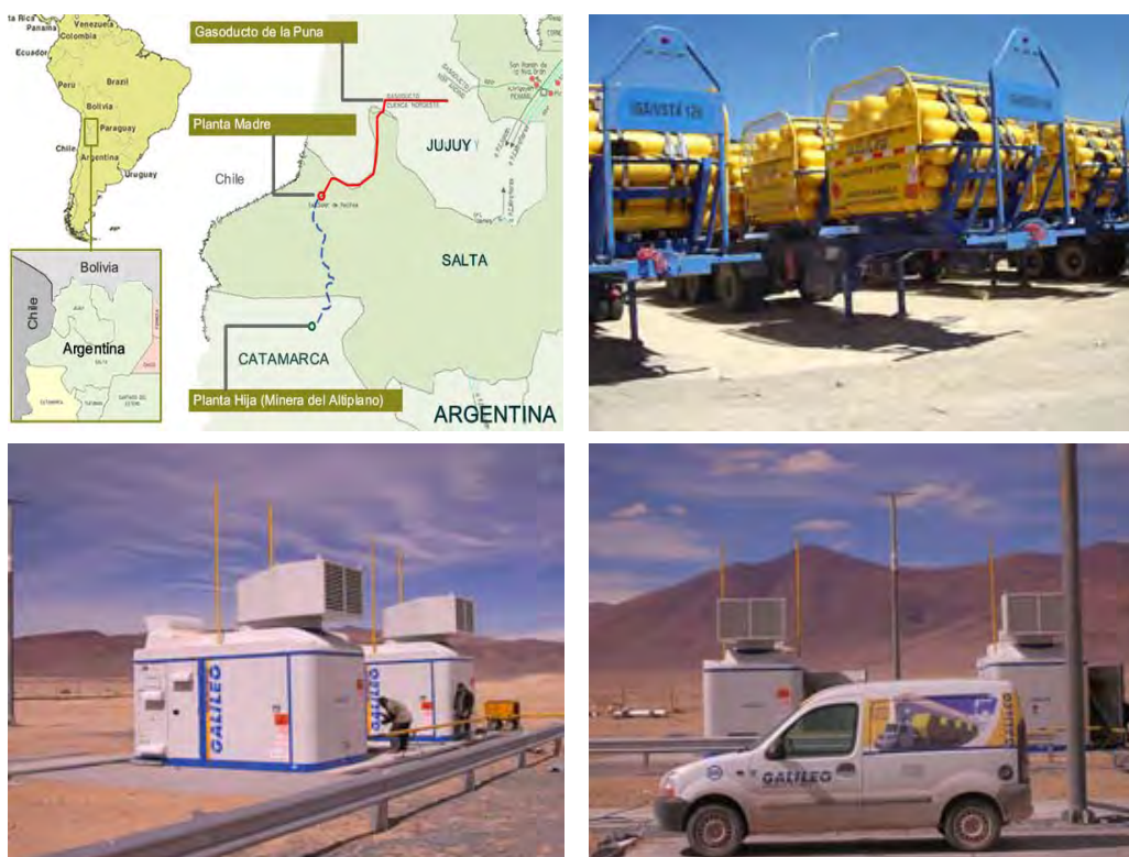
Abbildung 20: CNG Verdichtungs- und Versorgungsanlage in Minera del Altiplano im Norden Argentiniens (GNC GALILEO SA)
