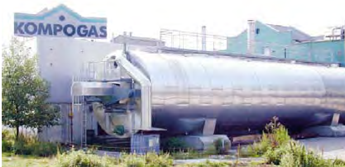
Abbildung 13: Kompogas Horizontal-Biogasreaktor, (PÖLZ UND SALCHENEGGER, 2005)
