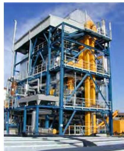
Biomasse-Dampfvergasung Güssing (Photo: TU Wien)
