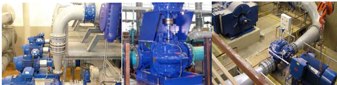
Abbildung 2: Unterschiedliche Bauweisen und Größenklassen von Kreiselpumpen, die im PaT-Modus betrieben werden (Quelle: KSB)
