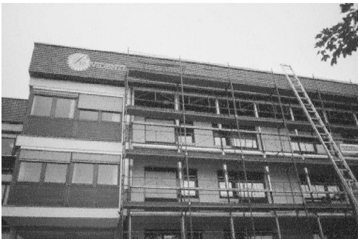
Altersheim mit Balkonen, schlecht wärmedämmend, schlechte Außentüren. Die Entscheidung war eine vorgehängte Glasfassade. Das war die kostengünstigere und die energetisch günstigste Lösung, denn damit hat man alle Wärmebrücken, die hier gelegen waren, weggebracht oder nahezu weggebracht. Und die Menschen haben einen zusätzlichen Raum bekommen.
