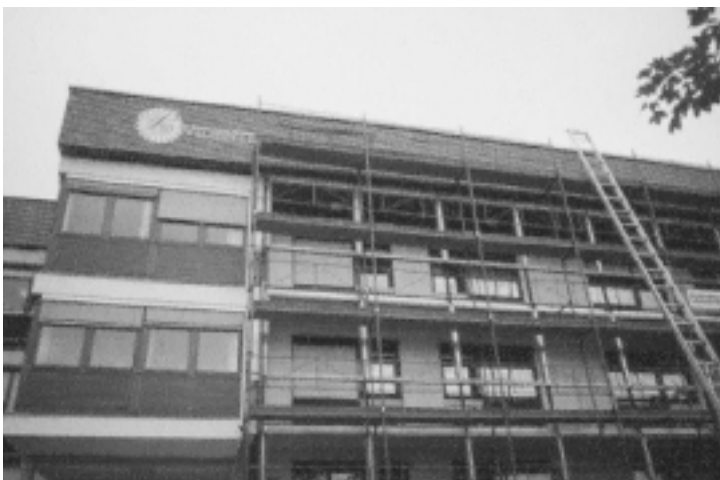
Altersheim mit Balkonen, schlecht wärmegeklämt, schlechte Außentüren. Die Entscheidung war eine vorgehängte Glasfassade. Das war die kostengünstigere und die energetisch günstigste Lösung, denn damit hat man alle Wärmebrücken, die hier gelegen waren, weggebracht oder nahezu weggebracht. Und die Menschen haben einen zusätzlichen Raum bekommen.
