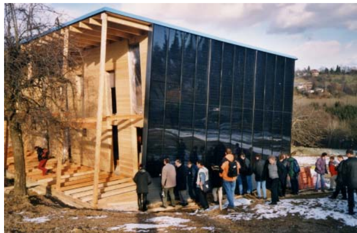
Abbildung 7.3: Testfassade mit 55 m 2 Kollektorfläche auf einem Zweifamilienwohnhaus in Graz
