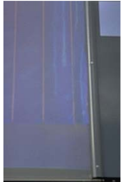
Abbildung A 1.8: Detailansicht des Absorberfeldes, durch Nässe beim Absorbereinbau sind Schlieren am Absorber sichtbar.
