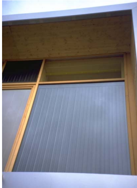
Abbildung A 1.21: Detailansicht des Kollektorfeldes mit Holzabdeckkleisten
