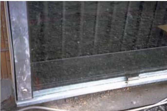
Abbildung A 1.33: Kollektordetail: Absorber, Glashalteprofil, Glashaltewinkel; Abdeckblech für die Sammelleitung. Der Kollektor ist direkt an der Ziegelmauer montiert.
