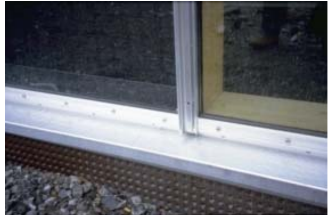
Abbildung A 1.54: Detailansicht Glasbefestigung unten. Bei dieser Anlage werden nicht Glashaltewinkel, wie sonst üblich, sondern Alu-Abdeckprofile für die Glasfixierung verwendet.
