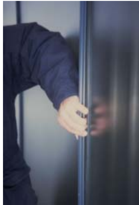
Abbildung A 1.39: Einige Schrauben des Alu-Abdeckprofils sind durch die Windsogbelastung gelockert bzw. fehlen.
