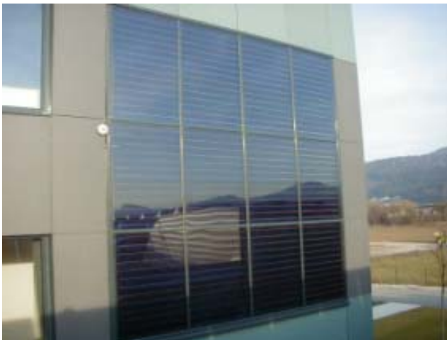
Abbildung 7.25: Versuchskollektor, 24,7 m 2 Bruttokollektorfläche über das 1. und 2. OG, Ansicht der Südfassade des Verwaltungsgebäudes
