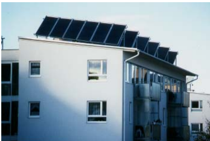
Abbildung 5.15: Abschattung durch aufgeständerte Kollektoren
