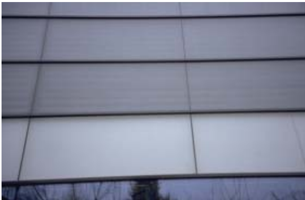
Abbildung A 1.50: Die Südfassade besteht aus den Elementen: Fenster, undurchsichtige Glasfassade und Fassadenkollektor
