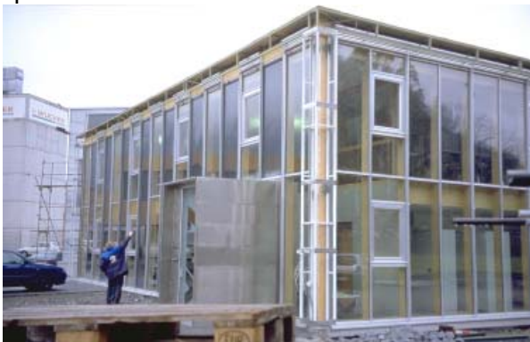
Abbildung A 1.51: Ost- Südansicht des Bürogebäudes C3 mit integrierten Fassadenkollektoren in der Südfassade
