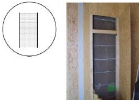
Bild 9: Unverputzter Schornstein hinter einer OSB-Platten-Verkleidung
