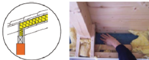
Bild 5: Geöffneter Traufanschluss, mit Feuchteschaden im Neubauzustand
