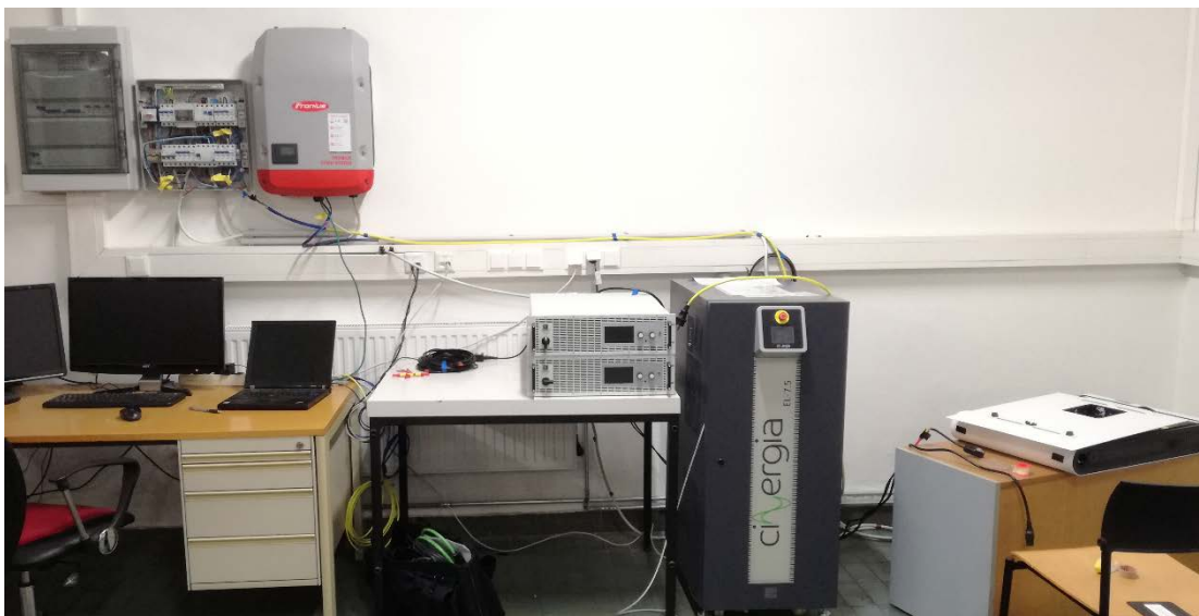
Abbildung 16: Ansicht des Versuchsaufbaus mit Verteiler- und Sicherungskasten, Gleichspannungsquellen, AC-Last und SolMate
