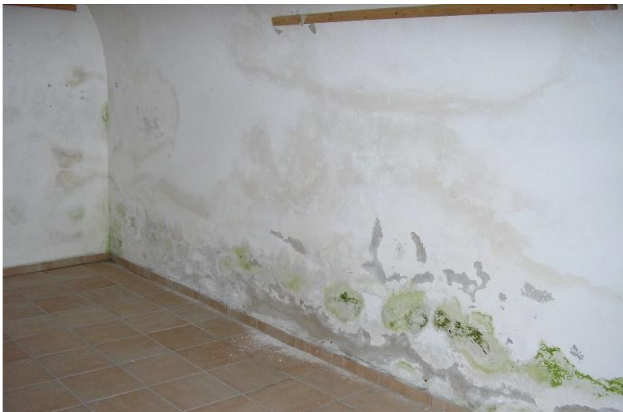
Abbildung 26: Beispiel für feuchtes Mauerwerk im Untergeschoss (Bildquelle: TU Wien, 2019)
