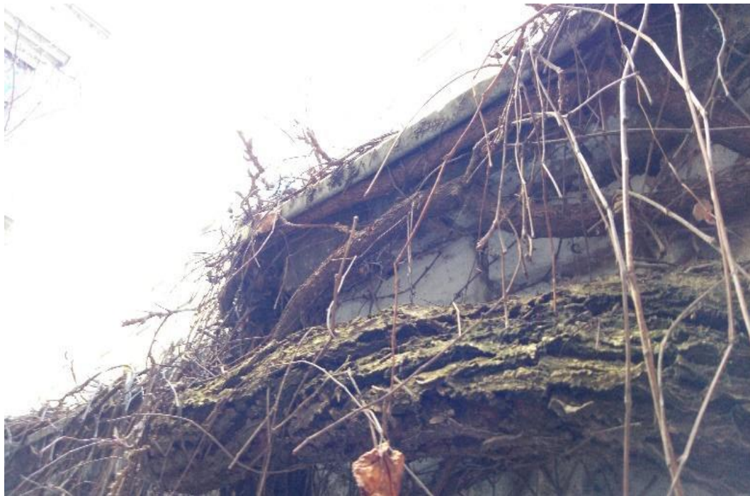
Abbildung 28: Beispiel für bautechnisch kritisch gewachsene Kletterpflanzen unter der Verblechung (Bildquelle: TU Wien, 2019)
