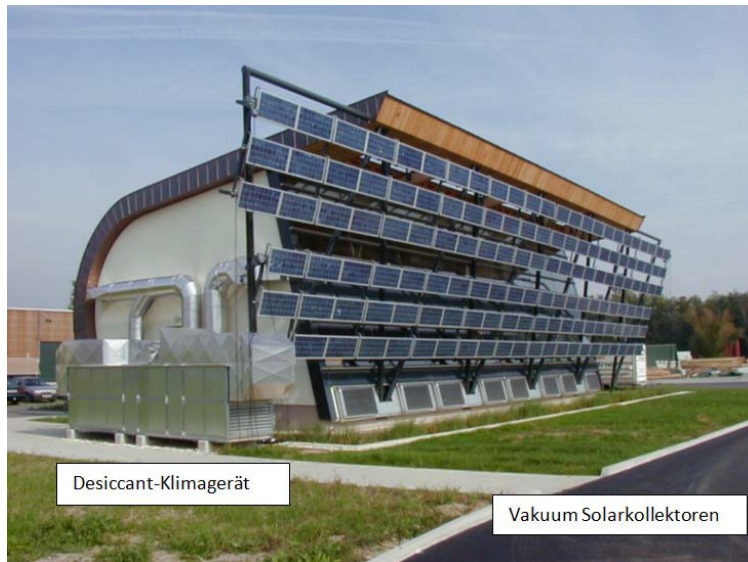
Abbildung 37: Desiccant- Klimaanlage im ÖKOPARK Hartberg, Betrieb seit September 2000 (Quelle: Endbericht, EU-Projekt ASODECO Funding Nr. FP5-EESD).
