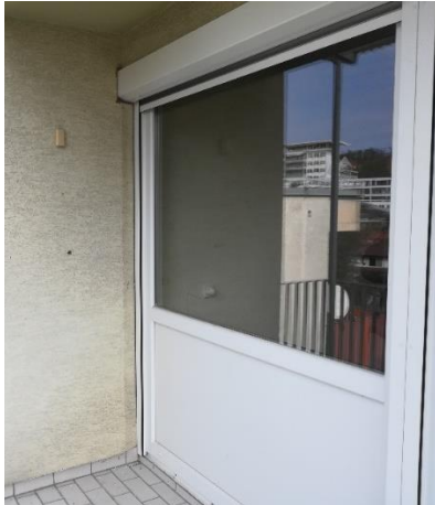
Abbildung 12: Wohnzimmerfenster der besichtigten Wohnung
