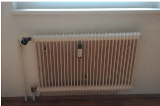
Abbildung 16: Ein Teil der Radiatoren ist noch Altbestand, ein Teil wurde bereits erneuert
