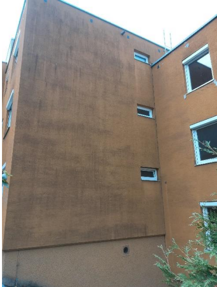
Abbildung 18: Die Fassade ist sanierungsbedürftig
