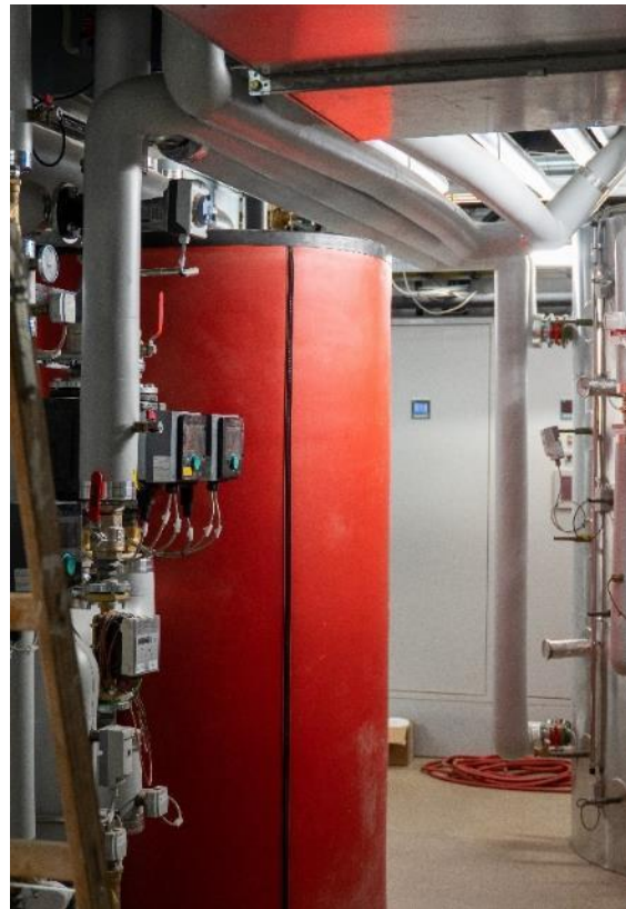
Abbildung 16 Dezentraler Pufferspeicher im Haupthaus, Quelle: ÖGUT
