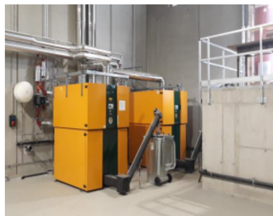
Abbildung 19 Hackgutkesselanlage im Heizhaus Quelle: AEE INTEC
