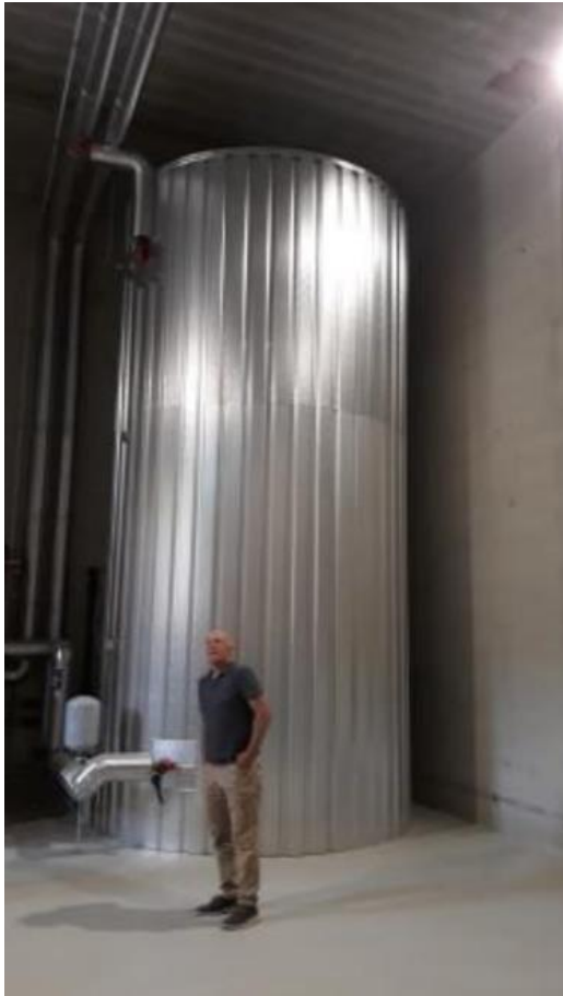
Abbildung 15 Zentraler Pufferspeicher 25m 3 im Heizhaus, Quelle: AEE INTEC
