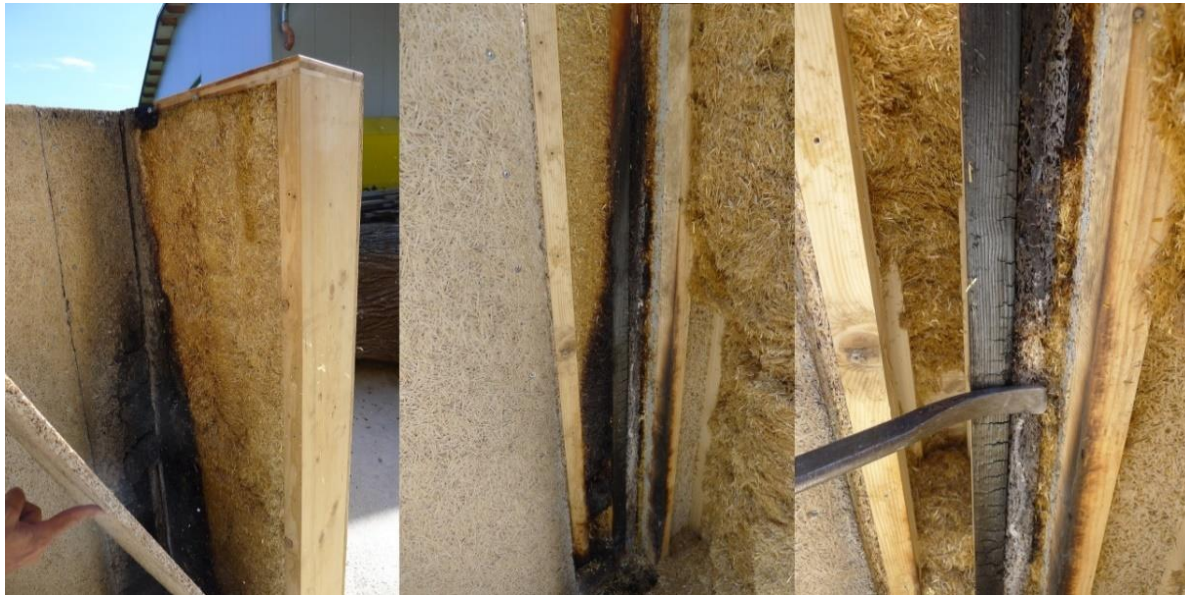
Abbildung 4-33: Geöffneter Prüfkörper mit HWL-Platten, Untersuchung der Verbrennungen; Quelle: Eigene Aufnahmen capital [ A ] architects, DPM
