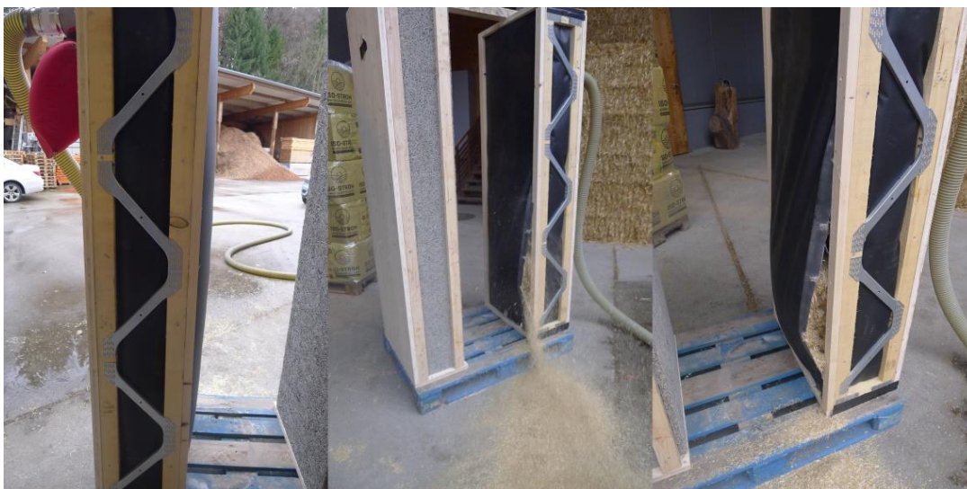
Abbildung 4-40: Bauchung der Fassadenbahn (links), Ausreißen aus der Befestigung (mitte), kaum befülltes Wandelement (rechts);
