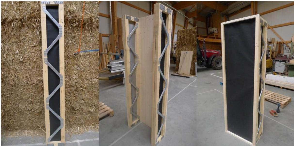
Abbildung 4-36: Herstellung des Wandelements mit Fassadenbahn Stamisol Safe one; Quelle: Eigene Aufnahmen capital [ A ] architects, DPM
