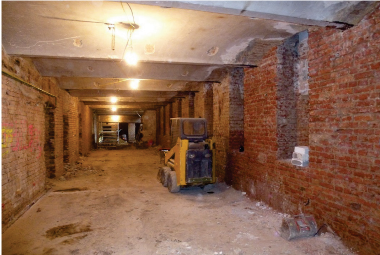
Abbildung 44: Zustand des Kellers bei der Probenentnahme
