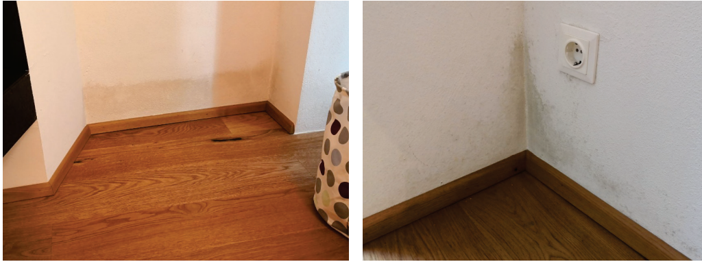
Abbildung 22: Schimmelpilzbildung an der Wandoberfläche des Kellergeschoßes im Bereich der Feuermauer
