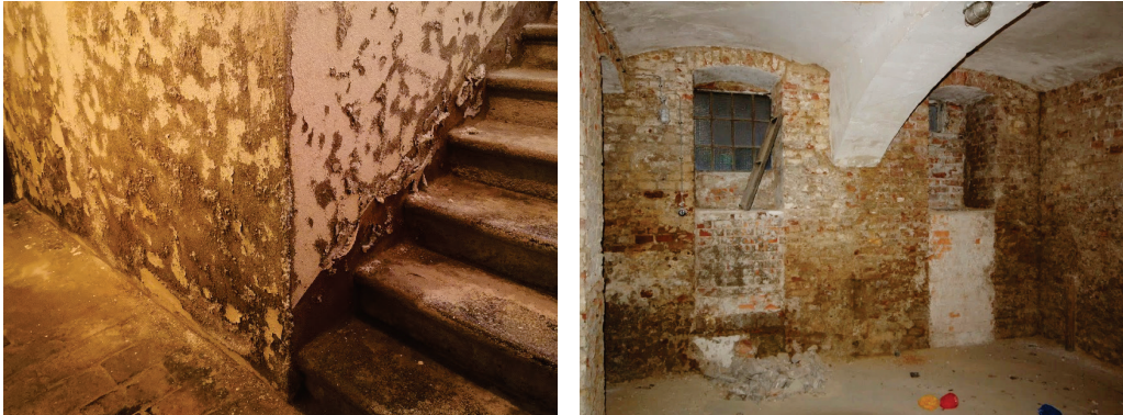
Abbildung 3: Massive Salzausblühungen bei unsaniertem Mauerwerk (links); nicht genutzter Keller mit unverputzten Ziegelwänden (rechts)
