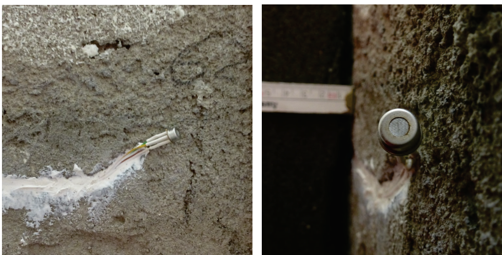
Abbildung 27: I2C-Kombisensor (HYT939) zur Messung von Temperatur und relativer Luftfeuchtigkeit; hier beispielhaft dargestellt an einer Wandoberfläche mit Grobputz; Situation vor der Montage der Innendämmung am Objekt A
