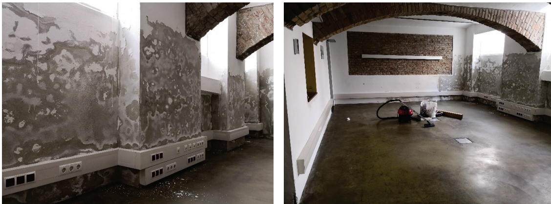
Abbildung 13: Feuchteschäden am erdberührten Mauerwerk infolge Salzausblühungen
