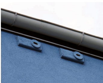
Nistkästen für Mauersegler die in das Wärmedämmverbundsystem integriert sind
