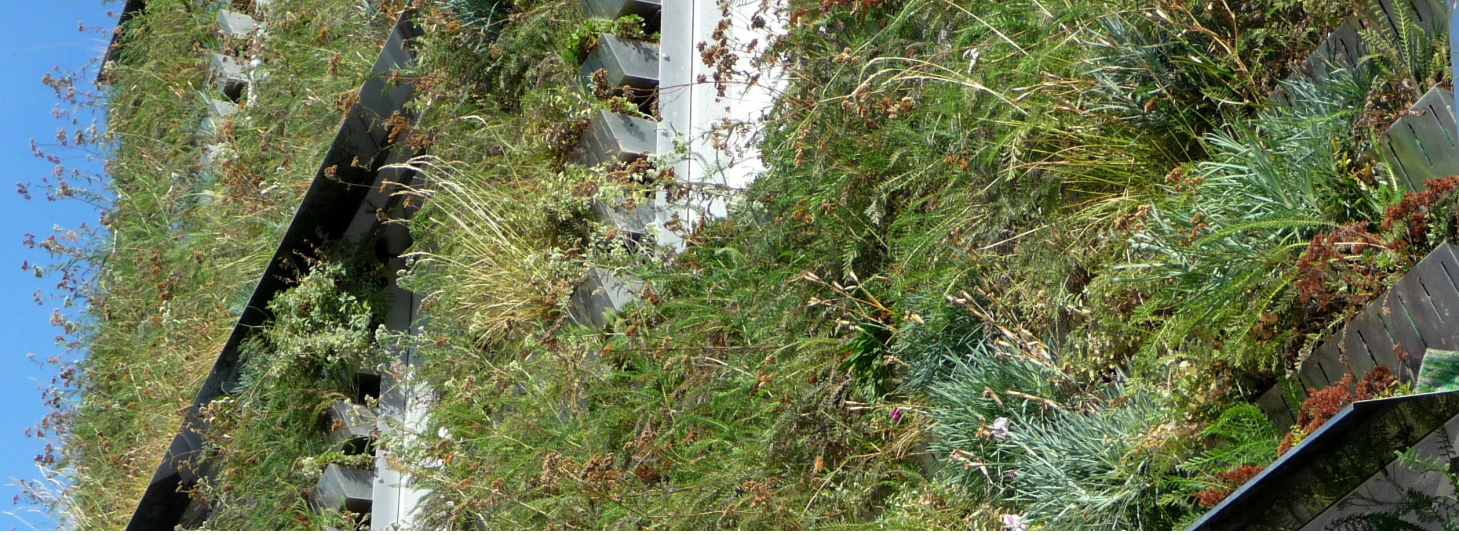
Eine fassadengebundene Begrünung mit linearen Trögen
