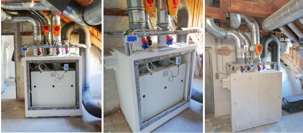
Abbildung 54: Lüftungsgerät mit E190-Einhausung und abnehmbarer Wartungstür; Quelle: Alpsolar Klimadesign
