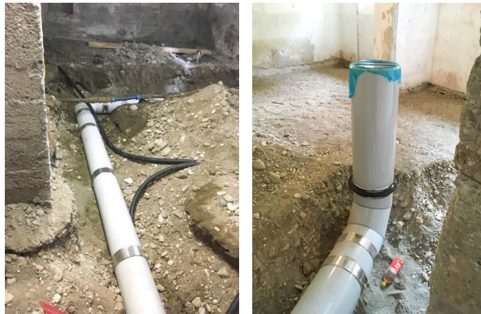
Abbildung 66: Vorisolierte Lüftungsrohre im Erdreich; Quelle: Alpsolar Klimadesign
