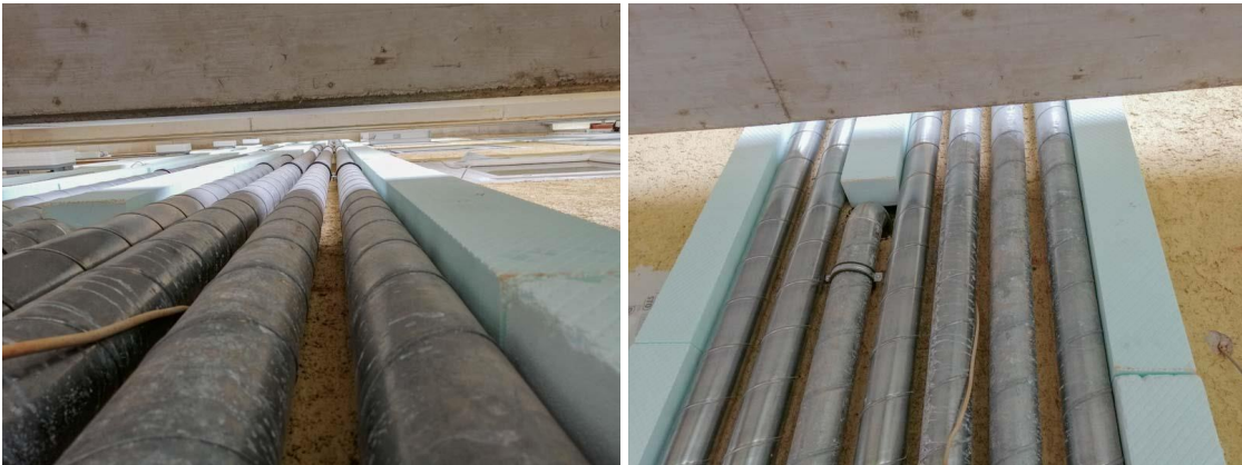
Abbildung 69: Leitungsführung an der Fassade mit brandbeständiger Abgrenzung; Quelle: Alpsolar Klimadesign
