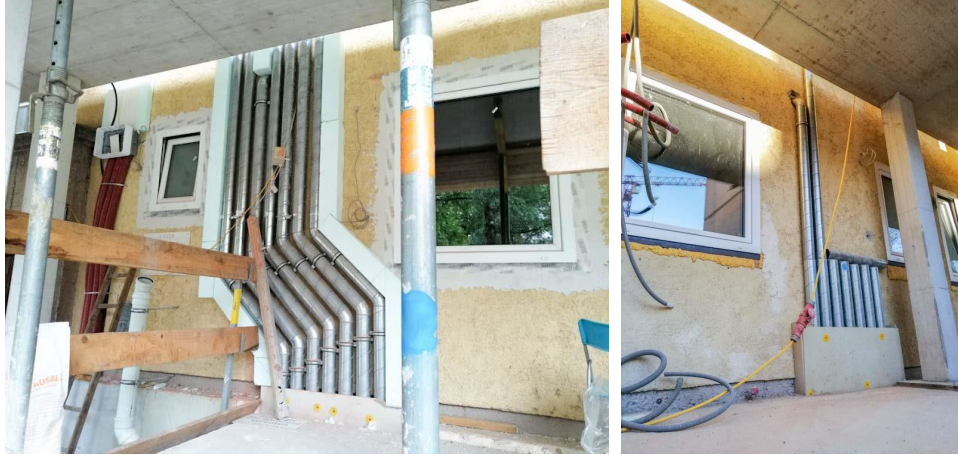
Abbildung 68: Leitungsführung an der Fassade; Quelle: Alpsolar Klimadesign
