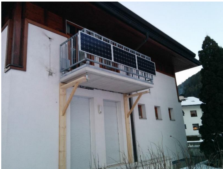
(c) Gesamtansicht THERM-opti-BALKON „System II“ mit installiertem Monitoringsystem
