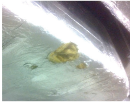
Abbildung 8: Beschädigung von Dämmung infolge Befestigung (Foto: IAT, TU Graz)
