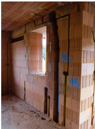
Abbildung 5: Stemmarbeiten auf der Baustelle für Elektroinstallationen und Wasserleitungen mit gängigem Werkzeug (wirbauen.org, 2017)
