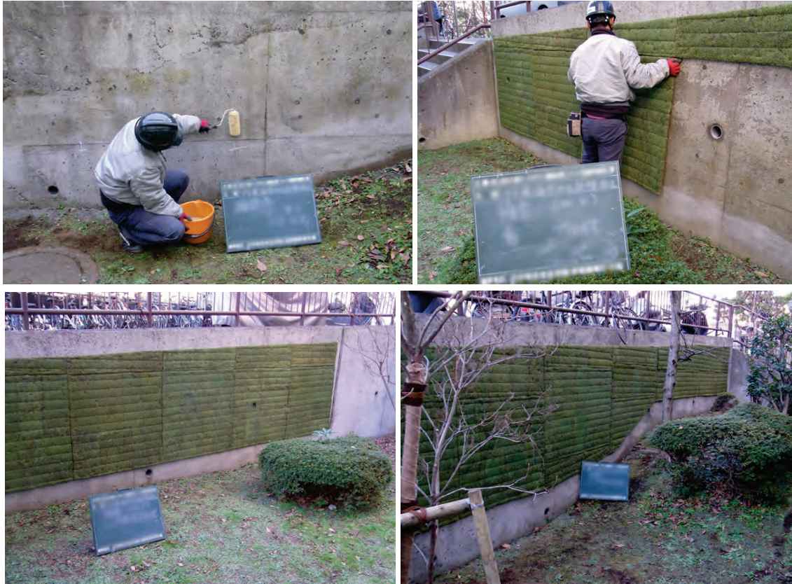
Abbildung 103 (l.o.), 104 (r.o.), 105 (l.m.) und 106 (r.m.): Aufbringung von Moosmatten auf Betonstützmauer: Auftrag von Kleber auf der Betonwand (l.o.), Aufkleben von Moosmatten auf die Betonwand (r.o.), fertig gestellte Stützmauer (l.m. und r.m.) Bildquelle: Website Fa. Moss Mokomoko
