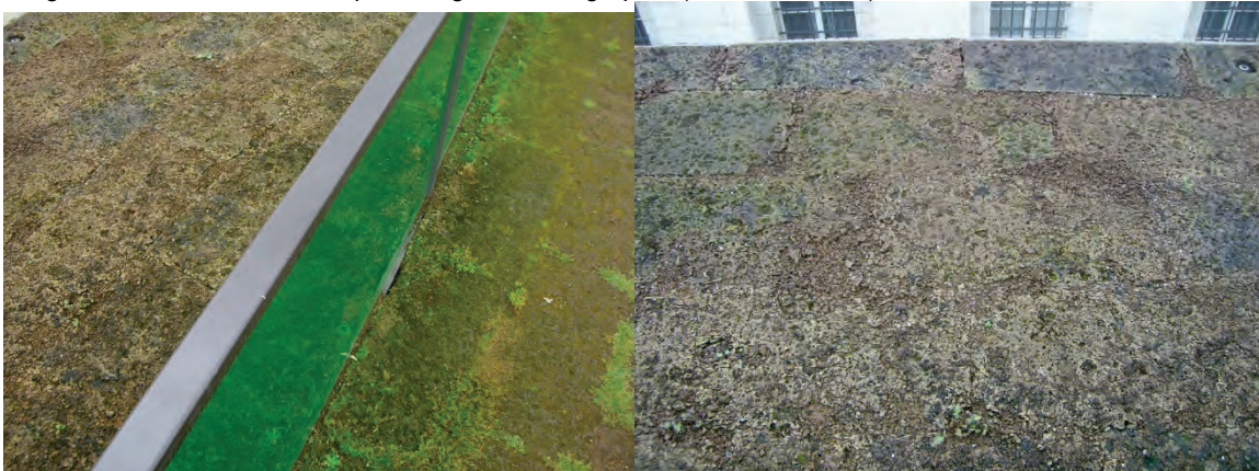
Abbildung 28 (links): Moose auf dem Flachdach und Vergleich der Steinarten, Bildquelle: Eigene Photographie – E.Heiduk (2007); Abbildung 29 (rechts): Moose und Abwitterung des Steins auf dem Flachdach Aarau; Bildquelle: eigene Photographie (E. Heiduk 2007)
