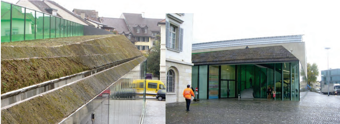
Abbildung 30 (links): Moose und Abwitterung des Steins auf den Dachschrägen - Detailansicht, Bildquelle: Eigene Photographie – E.Heiduk (2007); Abbildung 31 (rechts): Moose auf den Dachschrägen, Eingangsbereich, Bildquelle: eigene Photographie (E. Heiduk 2007)
