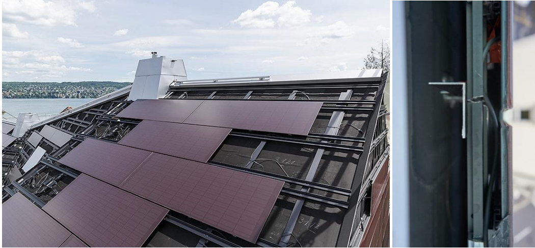
Abb. 19: Links: Dachansicht der PV-Paneele WH Solaris. Rechts: Befestigung der PV-Paneele WH Solaris. [13]
