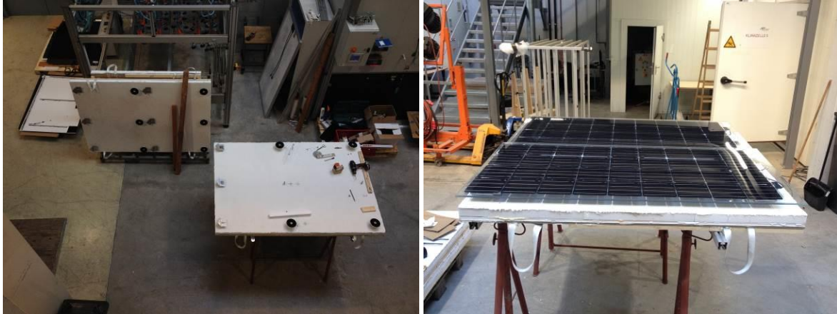
Abb. 53: Links: Montieren der Einhängehaken und Klettsteller Rechts: Probemontage der PV-Module (eigene Darstellung)
