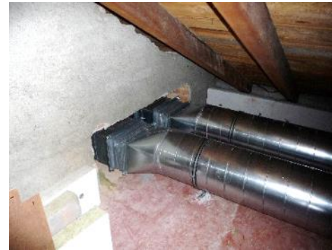
Lüftungszentrale auf dem Dachboden installiert
