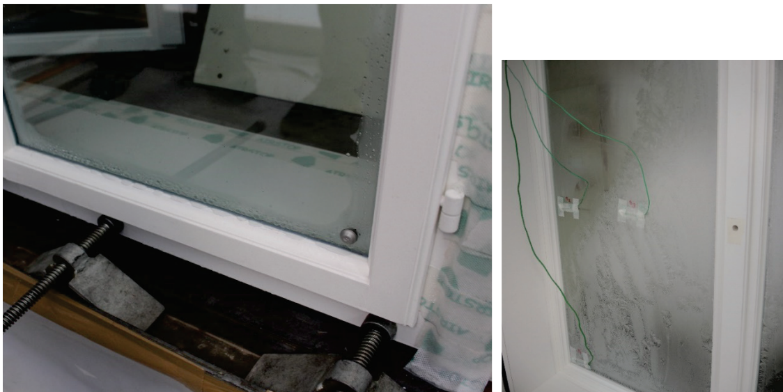
Abbildung 89 und 90: Kondensat im Randbereich des Vakuumglases an der Rauminnenseite und Eisbildung am Floatglas des äußeren Fensterflügels.
