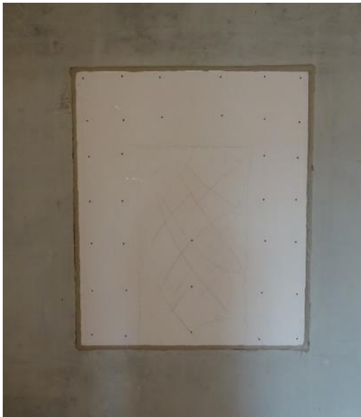
Abbildung 10: Hochschalldämmende Prüfwand in der Fensteröffnung
