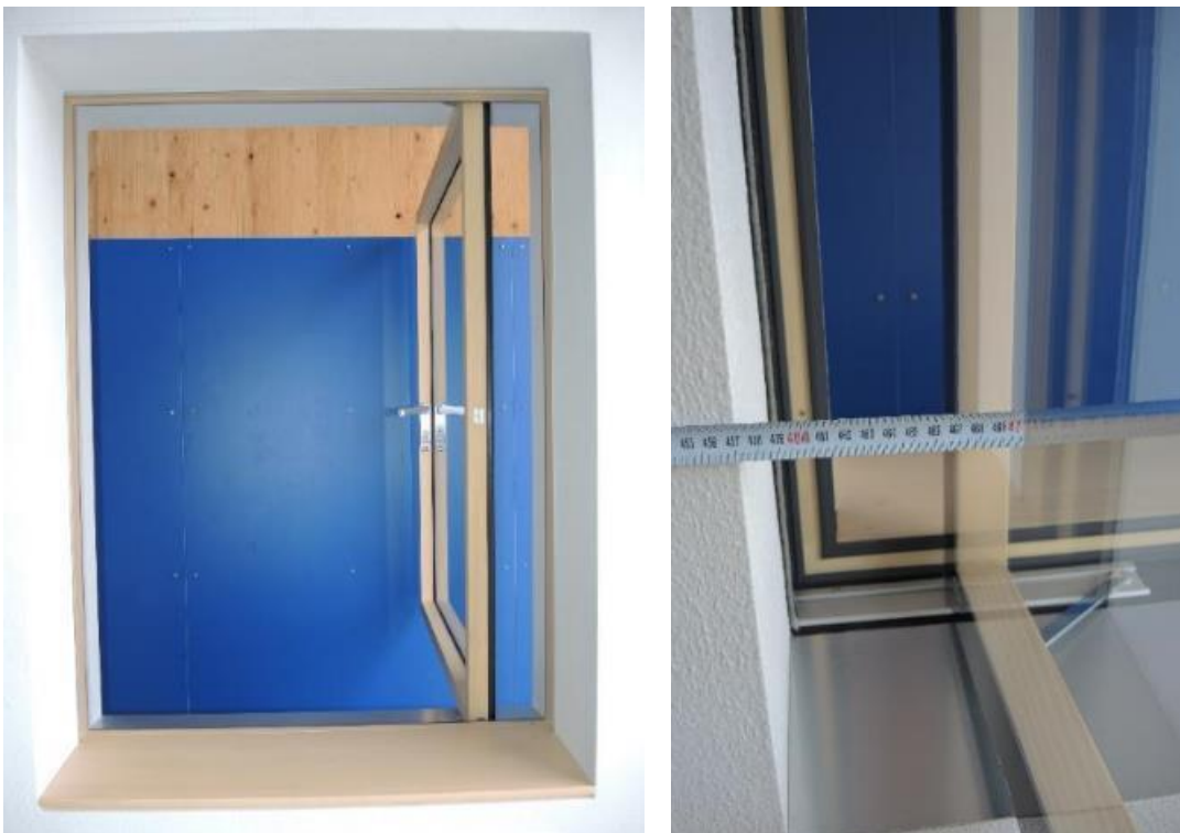
Abbildung 43: Geöffnetes Fenster mit seitlichem Putzspalt
