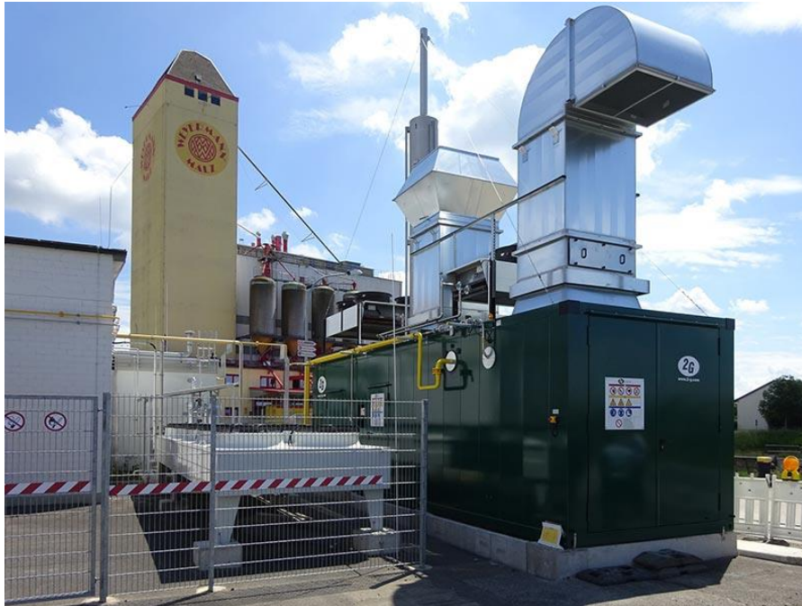
Abbildung 24: Das H2-BHKW agenitor 406 SG von 2G (Amberg-Weiden, 2020)
