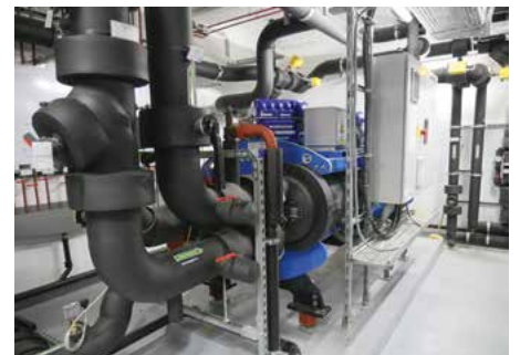
Entrance area (above), cooling machine (below), Photos: Projektfabrik Waldhör KG
