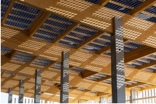
Abbildung 7: Dach mit Glas-Glasmodulen © Kioto Photovoltaik GmbH
