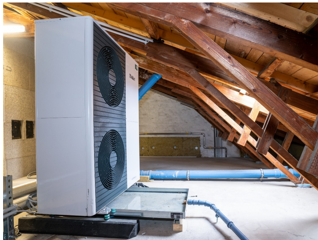
Luftwärmepumpe im Dachraum Quelle Sozialbau AG
