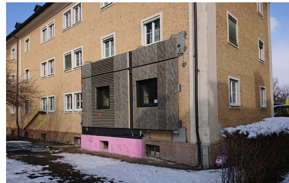
Projekt Wohnen findet Stadt! Teils vorgefertigte Multifunktionsfassade. Quelle: Fh Salzburg; Schweizer et. al
