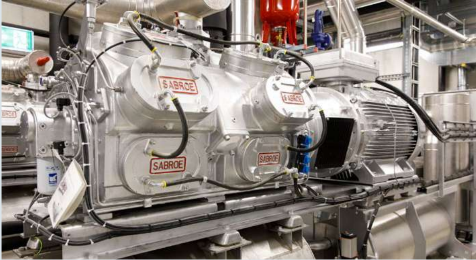
Heat pump at Therme Wien, photo: Wien Energie/Max Kropitz
