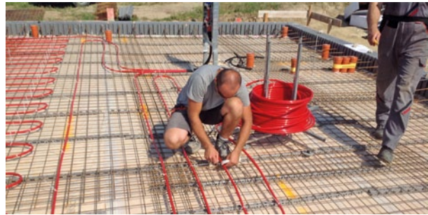
Equipping a floor structure for storing heat, Photo: Aichinger Hoch- u. Tiefbau GmbH
