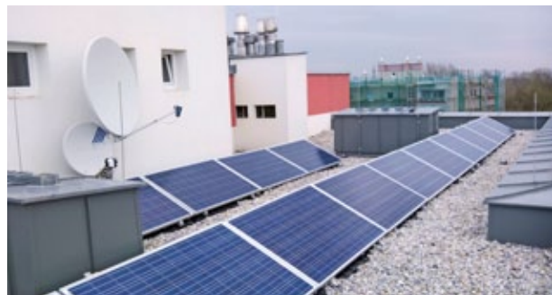
PV-Anlage im Porsche-Viertel Wiener Neustadt, Foto: Wien Süd
