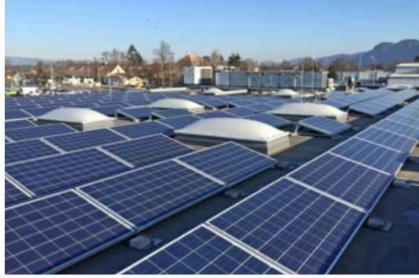
PV-Anlagen am Fachmarktzentrum in Klagenfurt, Foto: IEV AG
