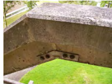
Provisorisch „geflickte“ Betongeländer der Fluchttreppen
