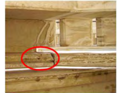
starke Frost-Wasserschäden mit Durchrostung der Bewehrung
