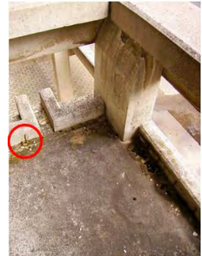
Frostschäden durch Verunreinigung der Betonoberfläche
