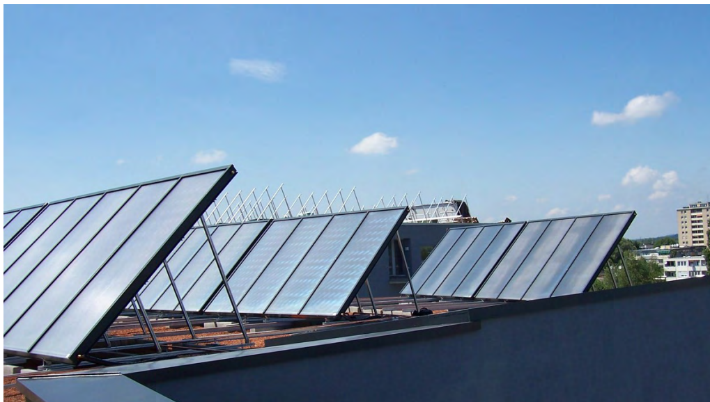
Solarkollektoren 45° aufgeständert auf Flachdach
