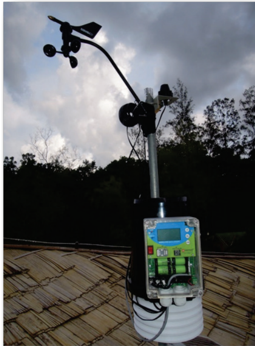
Abbildung 6: Wetterstation auf dem Dach des Zero Carbon Building
