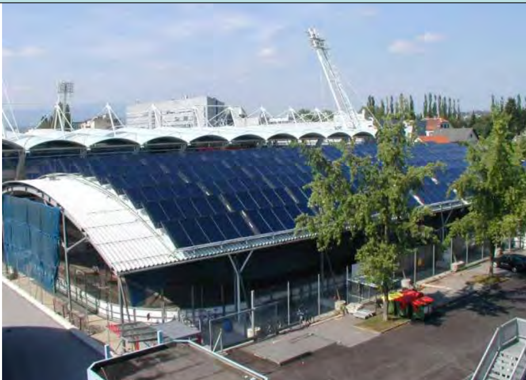
Bildtafel 3.7n: Solarthermische Anlagen Solarwärme für Fernwärme-Netze
