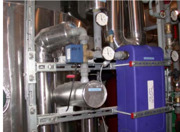
Abbildung 61: Detailansicht im Technikraum
