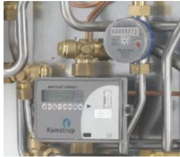
Abbildung 12: Standard bei der Erfassung des Wärmebedarfs in Zwei-Leiter-Netzen – Wärmemengenzähler und Wasserzähler in jeder Wohnungsstation (Bildquelle: Danfoss)
