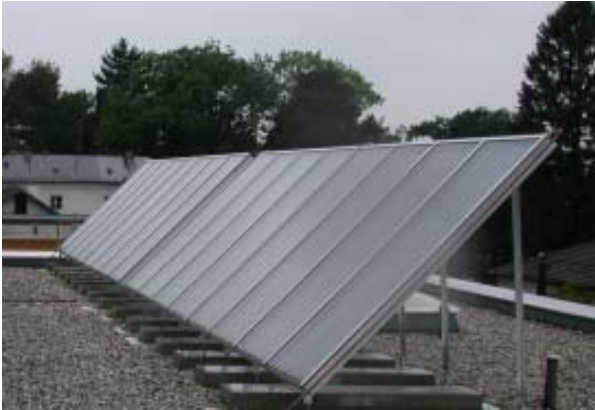
Abbildung 28: Anordnung der Kollektoren am Flachdach
