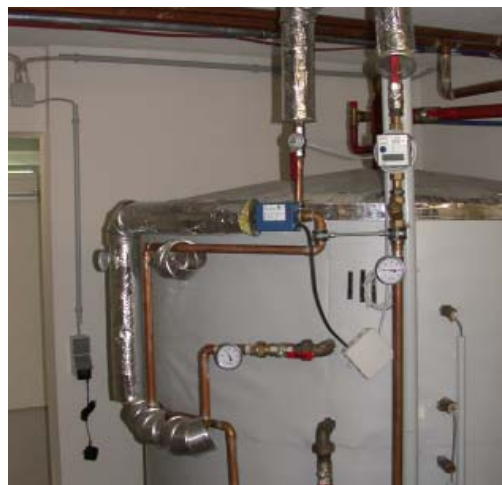
Abbildung 36: Detailansicht aus dem Heizhaus – der Energiespeicher ist bereits gedämmt, die Rohrleitungen waren zum Teil noch ungedämmt.
