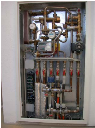
Abbildung 53: Wohnungsübergabestation in Unterputzausführung
