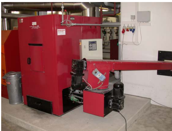
Abbildung 26: Pelletskessel zur Grundlastabdeckung
