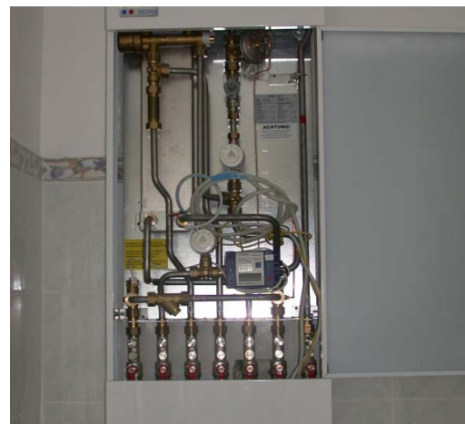
Abbildung 31: Ansicht einer installierten Wohnungsstation inkl. Wärmemengenzähler
