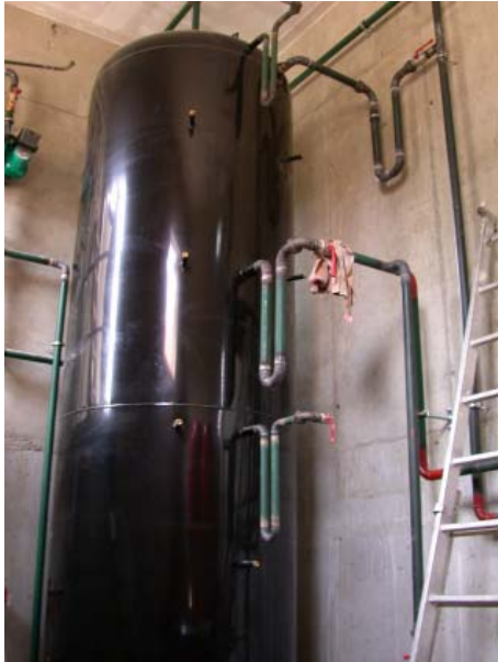
Abbildung 39: Ungedämmter Energiespeicher mit Rohranschlüssen und Thermosiphon
