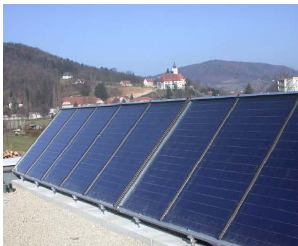
Abbildung 35: Ansicht der am Flachdach positionierten Kollektoranlage
