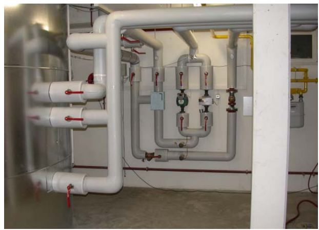
Abbildung 27: Detail zu Rohrführung und Dämmstandard im Heizhaus
