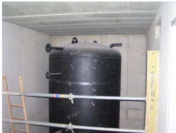
Abbildung 69: Ansicht des in der Technikzentrale befindlichen Energiespeichers
