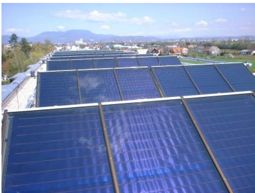
Abbildung 49: Ansicht der 96 m² großen Kollektorfläche am Flachdach des Demonstrationsobjektes „Seiersberg“
