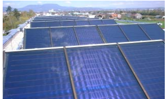
Abbildung 74: Ansicht der Kollektorfläche bei der Anlage in Seiersberg
