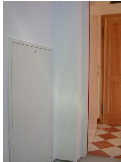
Abbildung 54: Nahezu unauffällige Wohnungsübergabestation in Unterputzausführung mit geschlossener Abdeckung
