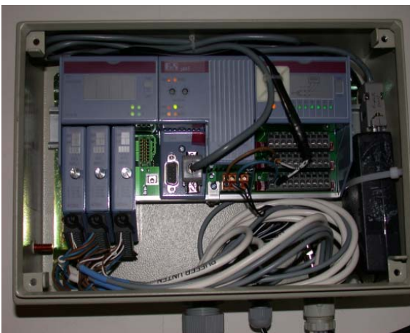
Abbildung 30: Ansicht des fertig verdrahteten Datenloggers
