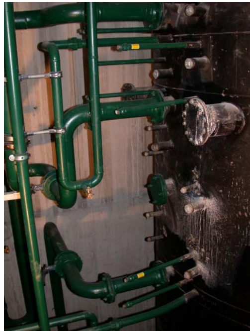
Abbildung 46: Bereits im Technikraum positionierter Energiespeicher mit sämtlichen Rohranschlüssen und Tauchhülsen für die Temperatursensoren.
