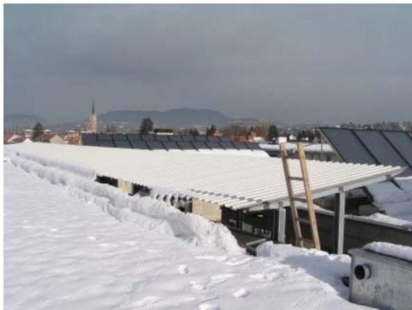
Abbildung 68: Teilansicht der 160 m 2 umfassenden Kollektorfläche
