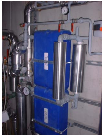
Abbildung 64: Ansicht des externen Solarwärmetauschers im Heizhaus.
