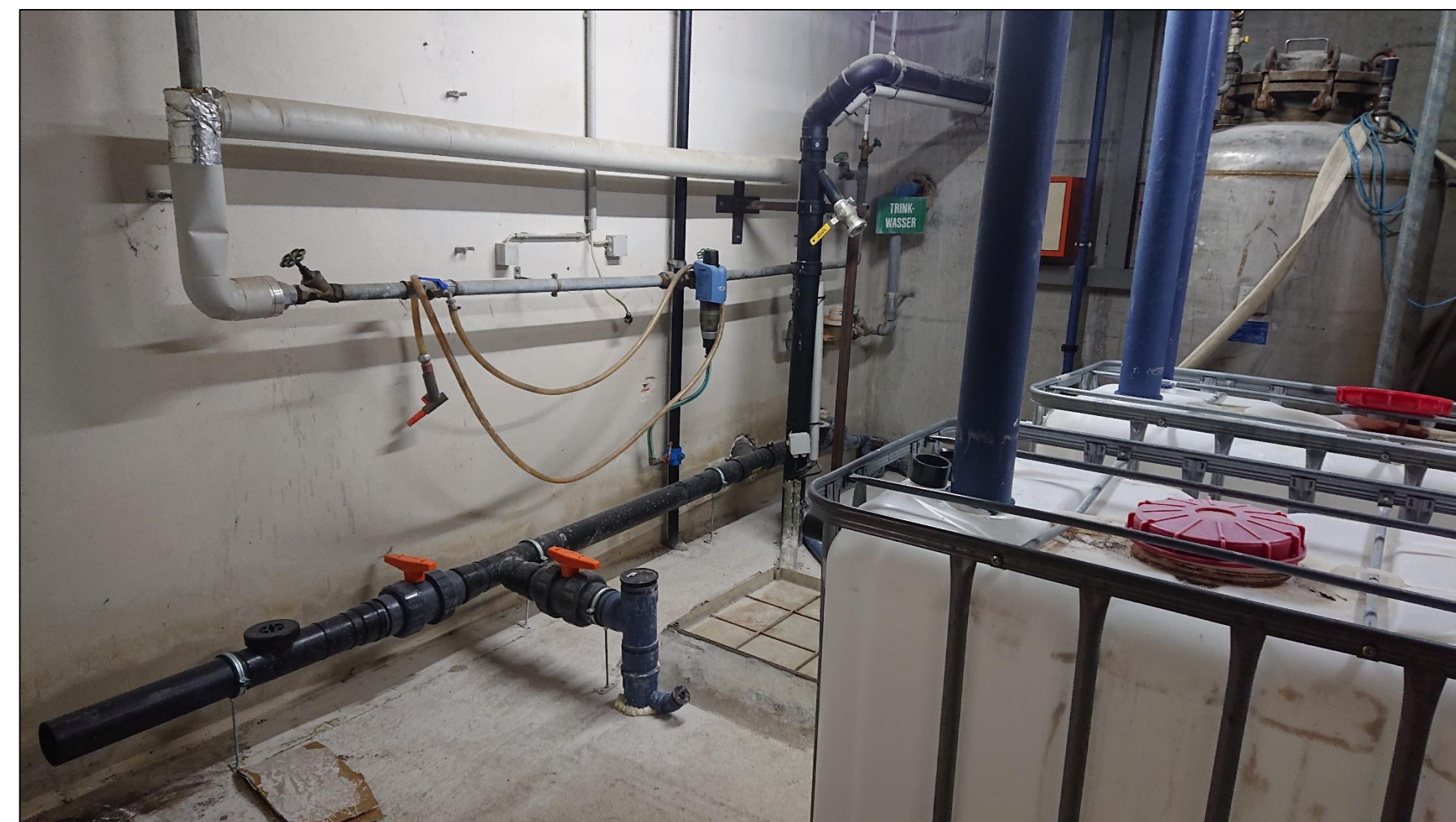
“Backend“ der Toilettenanlage, rechts sind die beiden Sammelbehälter zu erkennen.
