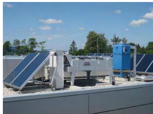
Abbildung 10 - Blick auf die Rückkühlwerke
